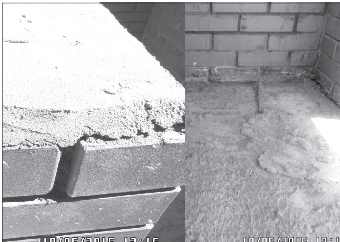
Вот такое качество лоджий и подоконников у «эффективных» строителей ООО «Брик» при сдаче новых домов при бюджетной отделке! А что они будут творить при капитальных ремонтах?
